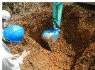
漏水箇所特定
