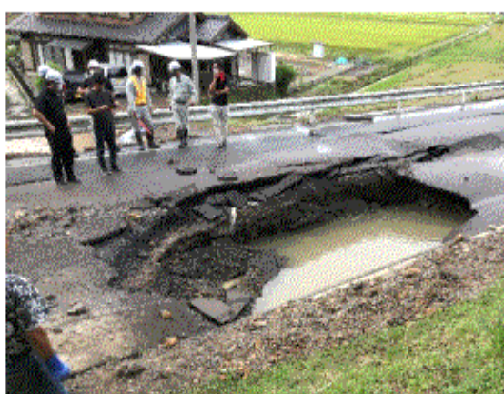
道路陥没状況
