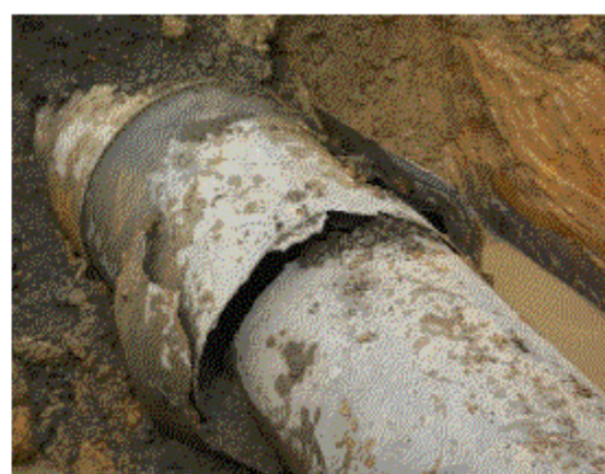
管体破裂状況
